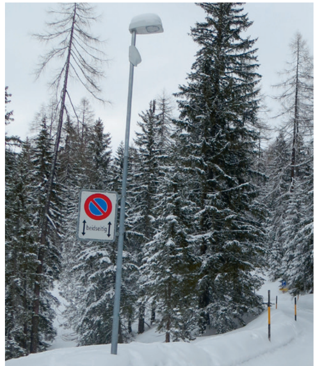
Strassenbeleuchtungskandelaber in Davos Laret mit gut sichtbarem Radarsystem
