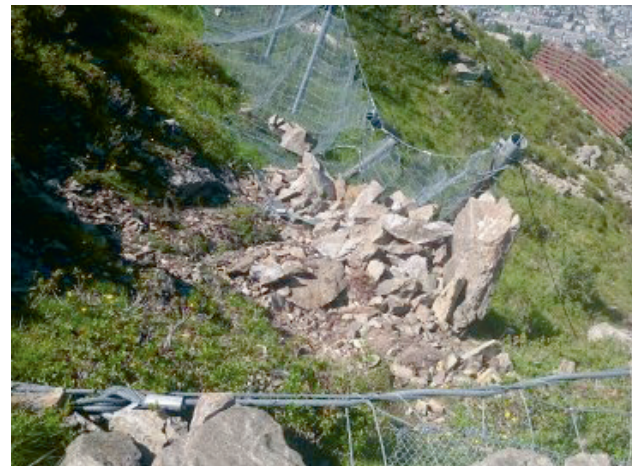
Lawinerverbauung Duchli, beschädigtes Schneenet
