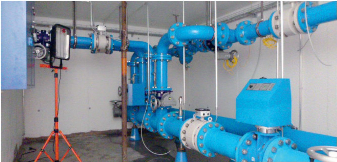
Innenleben des Abgabeschachts Bünnda mit den Mess- und Regeleinrichtungen. Links oben ist der zukünftige Abgang in Richtung Reservoir Büelen zu erkennen.
