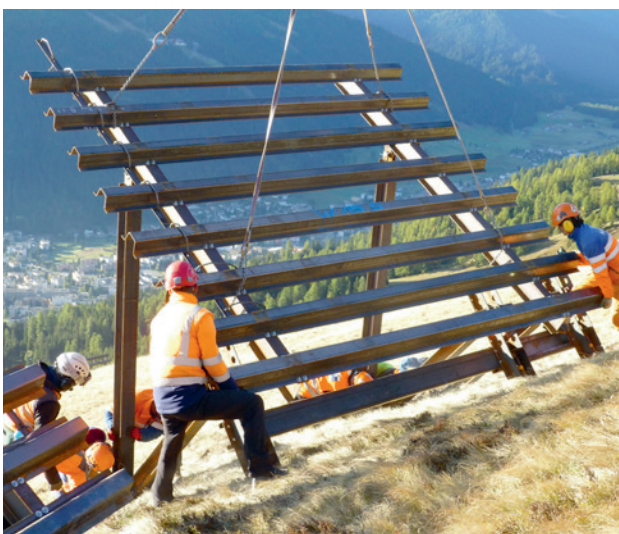
Lawinerverbauung Dorfberg, mit dem Helikopter wird die im Tal montierte Schneebrücke auf die Anker gesetzt
