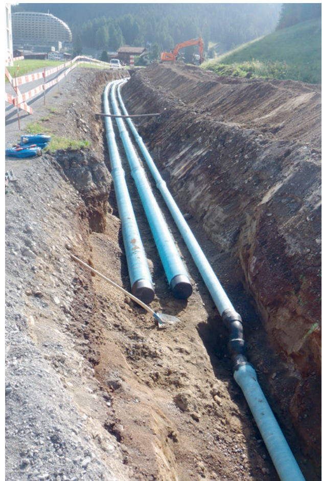
Ansicht der neuen Leitungen im Bereich des Bedrawegs. Die beiden grossen Leitungen dienen der Wasserversorgung, die kleine der Beschneigung der Langlaufloipen.
