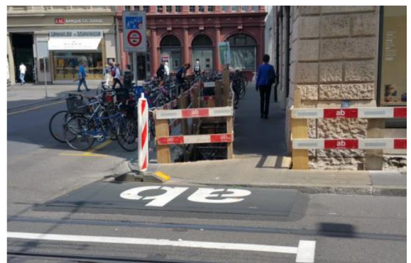
Aufgelegte Stahlplatte mit Anrampung
