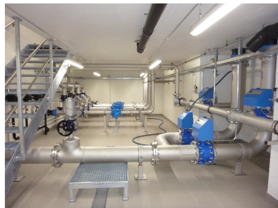
Die Anlage erfüllt alle Anforderungen einer modernen Wasserversorgung.
