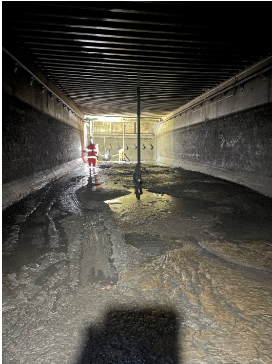
Blick in das Regenbecken Tanne mit am Boden abgelagerten Feststoffen
