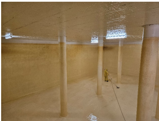
Regelmässiger Unterhalt und die alljährliche Reinigung der Reservoirs sorgen für gleichbleibend hohe Wasserqualität – im Bild das Reservoir Schiatobel, das 2 Millionen Liter Wasser fasst.
