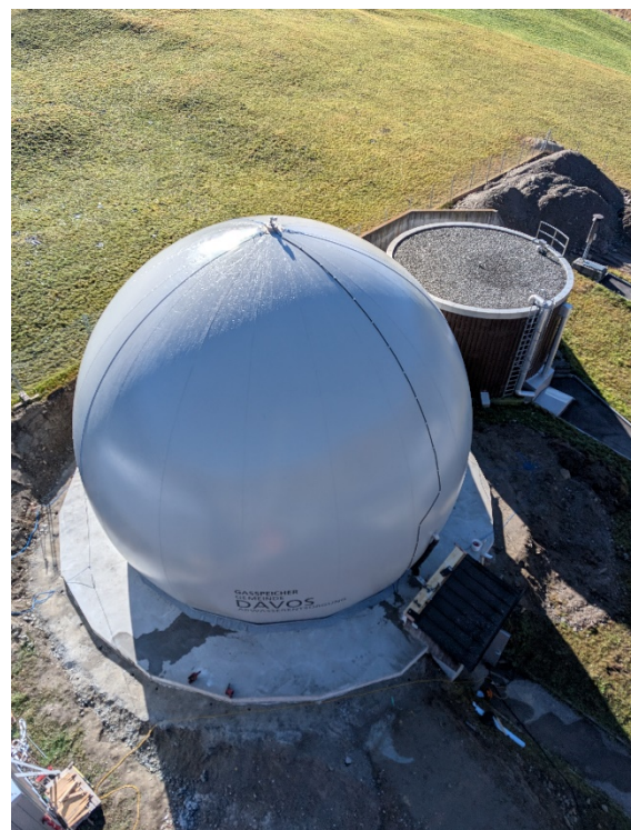
Ansicht des neuen Gasspeichers auf der ARA Davos
