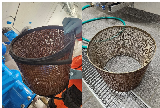
Vorher und nachher – Filter sorgen dafür, dass mineralische Schwebeteilchen aus den Quellen nicht ins Netz gespült werden. Diese Filter müssen regelmässig gereinigt werden.
