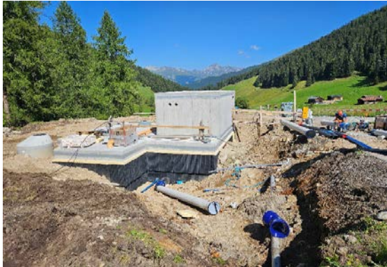
Vom neuen Pumpwerk Bäbi wird das Trinkwasser fürs Sertig Dörfji künftig...
