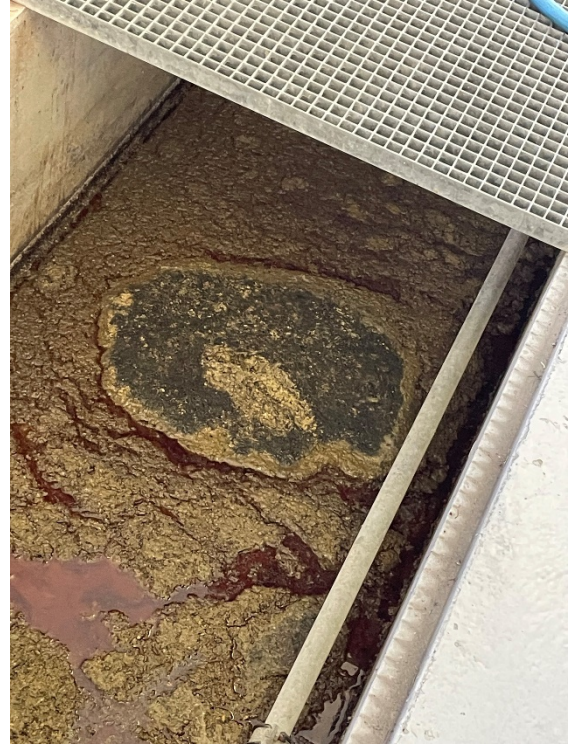
Sand-Fettfang mit dem rot eingefärbten Heizöl
