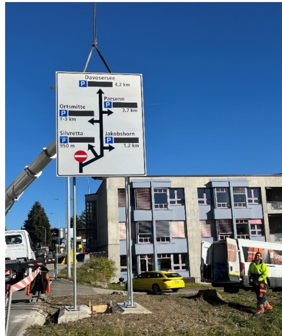
Installation Anzeigetafel Parkleitsystem beim Spital
