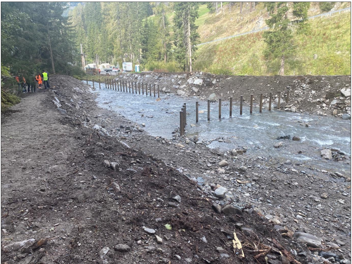
Flüelabach: Querrechen und Längsrechen, Blick Richtung Fährich
