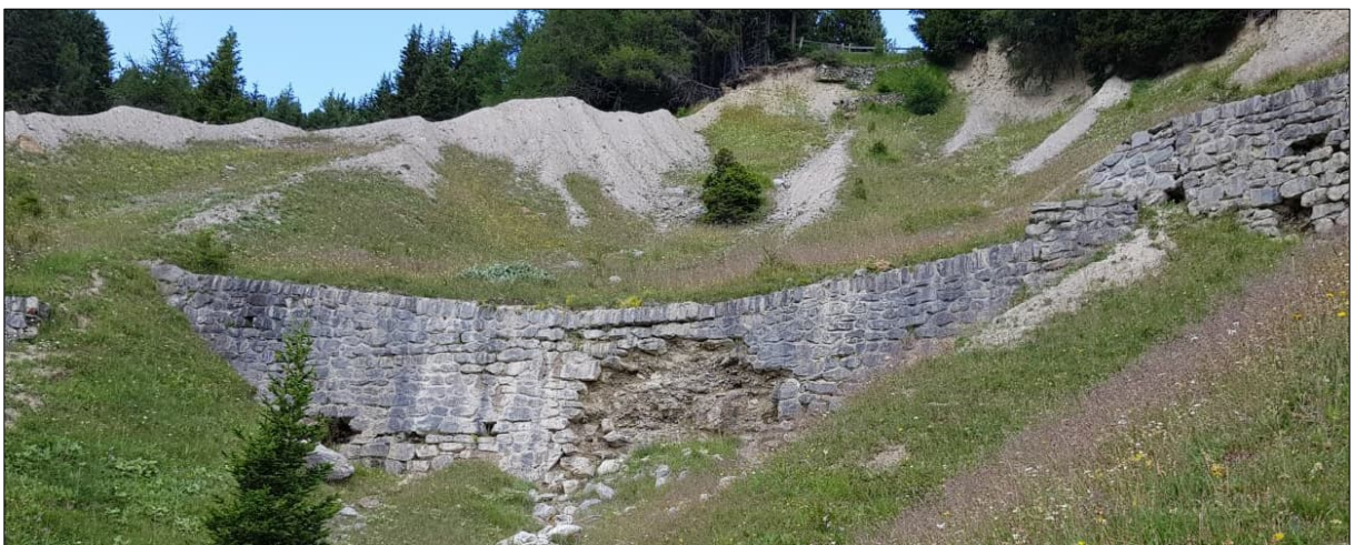
Schadhaftes Sperrbauwerk, siehe Technischer Bericht DIAG (Sperr S9, Juli 2020).
